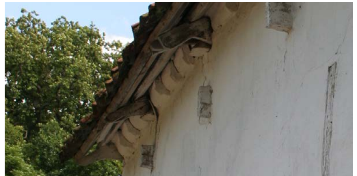
Gennemstukne bjælkehoveder for strytrumskonstruktion, fritsiddende skalke i tagudhænget samt sugefjæld af tagsten, nordfacaden
