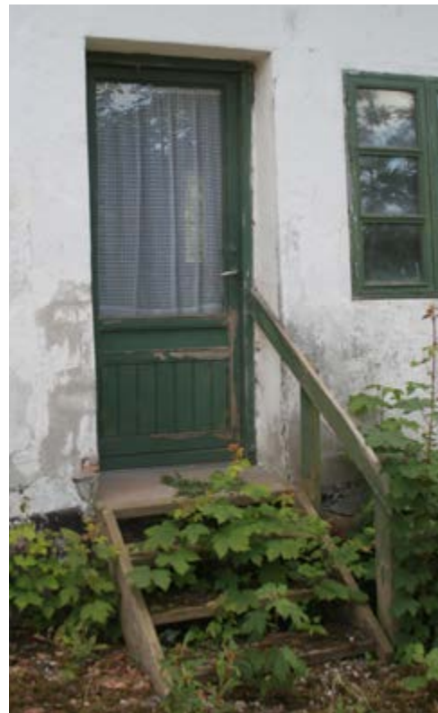
Trætrappe og nyere bryggersdør rykket langt ind i murhullet, nordfacade
